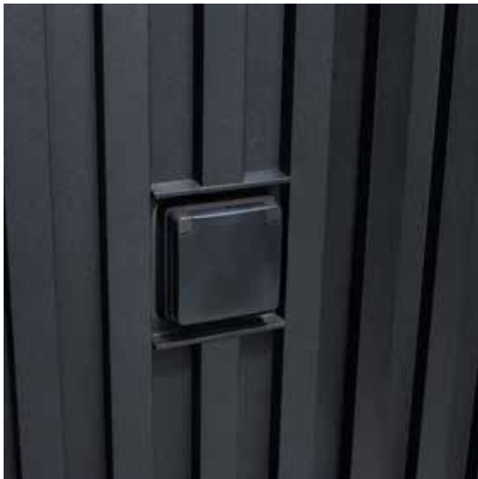
Intégration d'une prise de courant
